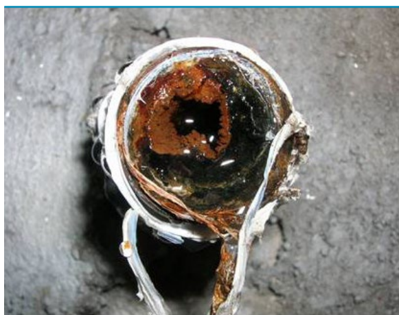
El tubo está casi obstruido con escama.
